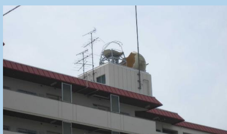
写真左: 受水槽の被害 写真右: 高架水槽の被害 写真出典: 仙台市
