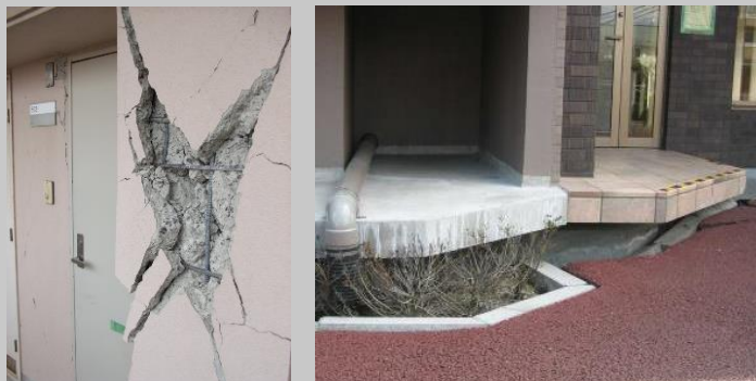
写真左: 玄関脇の壁面損傷(玄関扉の開閉が困難に) 写真右: 建物周辺が沈下 写真出典: 仙台市 「分譲マンション防災マニュアル作成の手引」
