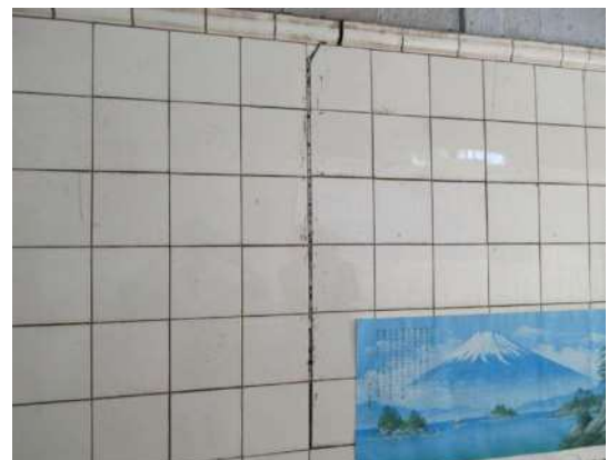
写真 3-1-115 目地に沿ったタイルのクラック
