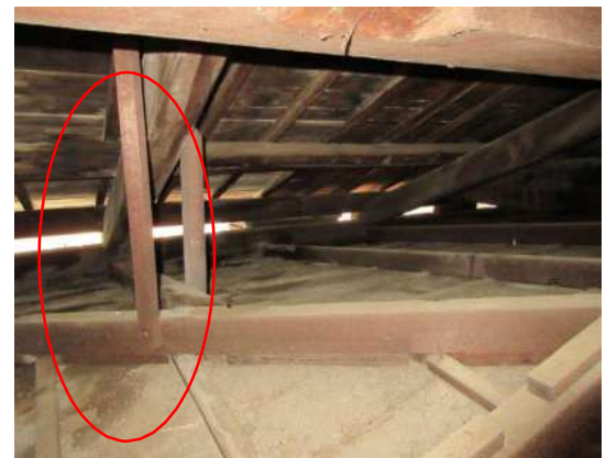
写真 3-1-137 雨漏りが吊木を伝い天井板に至る
