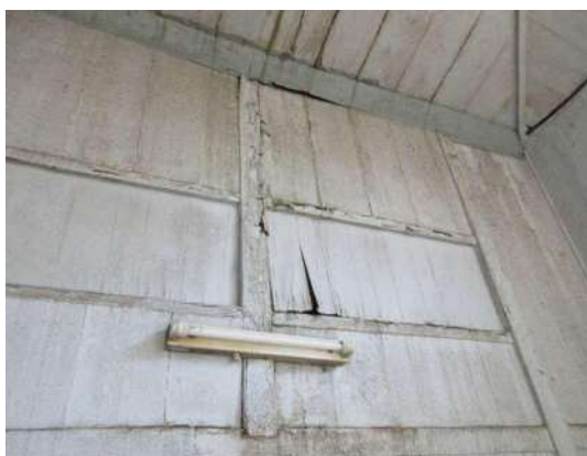
写真 3-1-110 束の腐朽と楣の圧壊（浴室（女））
