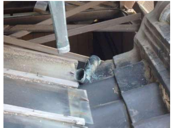
写真 3-1-103 縦樋の外れと排水経路不良
