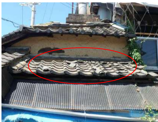
写真 3-1-159 落下した瓦が下屋屋根に乗る
