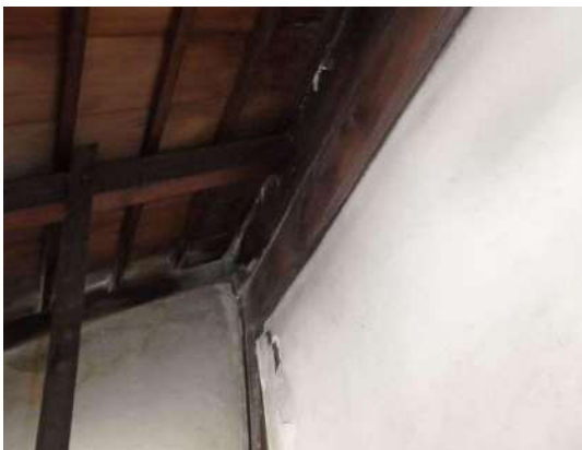
写真 3-1-92 縁側 垂木掛け付近の雨染み
