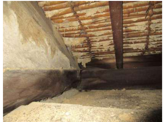
写真 3-1-106 桁廻りの雨染み
