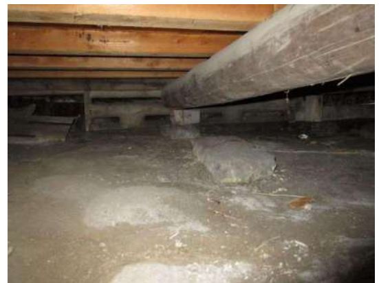
写真 3-1-35 床組は後補材が多い
