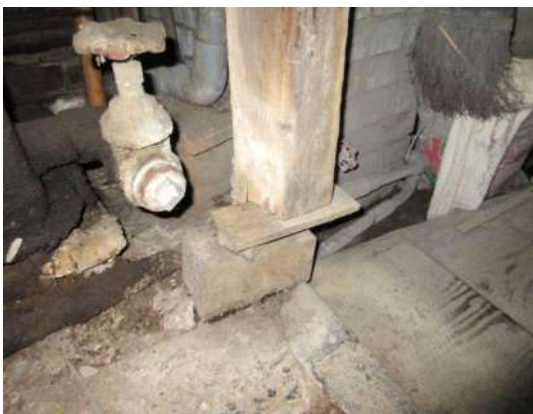
写真 3-1-144 柱脚の不具合
