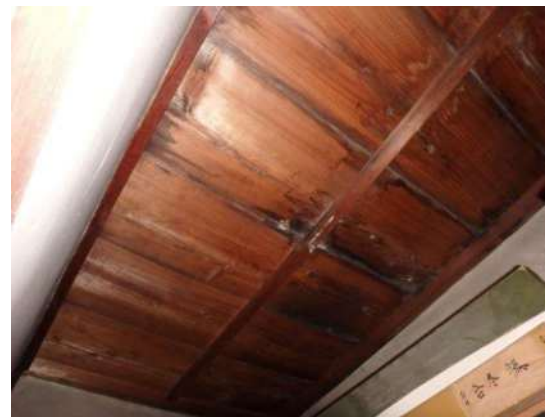
写真 3-1-89 押入天井の雨染み
