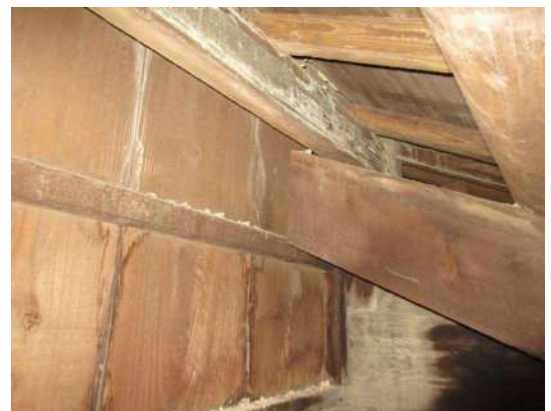
写真 3-1-215 登梁の切断部 (Y13 通り)
