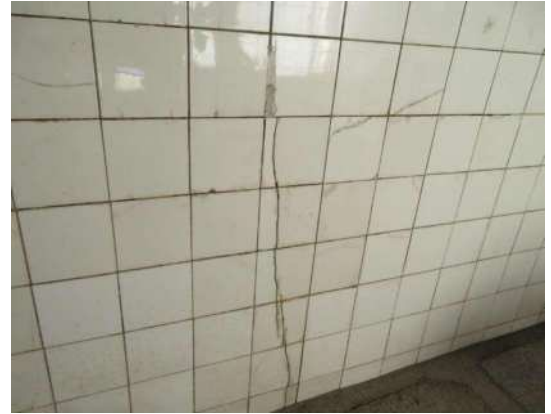
写真 3-1-117 東面の大きなクラック
