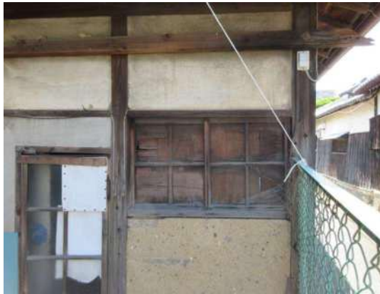
写真 3-1-165 窓ガラスの欠損
