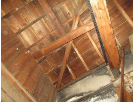
写真 3-1-231 梁桁に残る焦げ跡と 焦げ跡の無い野地板
