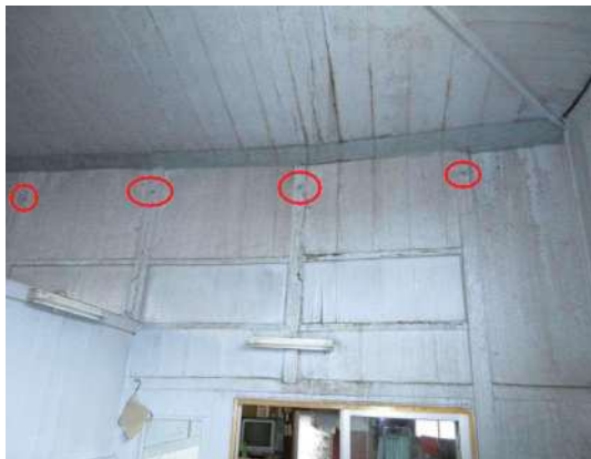
写真 3-1-36 浴室に露出したボルト頭部
