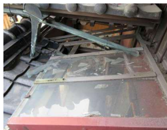
写真 3-1-64 ガラス天井の破損
