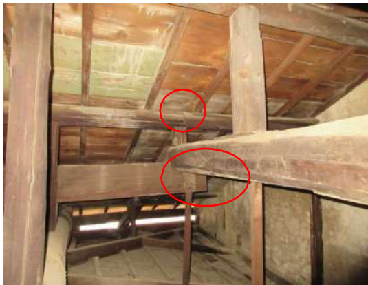
写真 3-1-206 対面まで届いていない敷梁と母屋の継手
