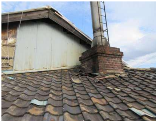
写真 3-1-157 各所に瓦の補修が見える
