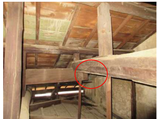
写真 3-1-135 敷桁端部が対面部材まで届いていない
