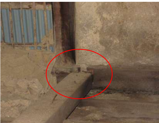
写真 3-1-140 妻桁の腐朽により仕口に不具合発生
