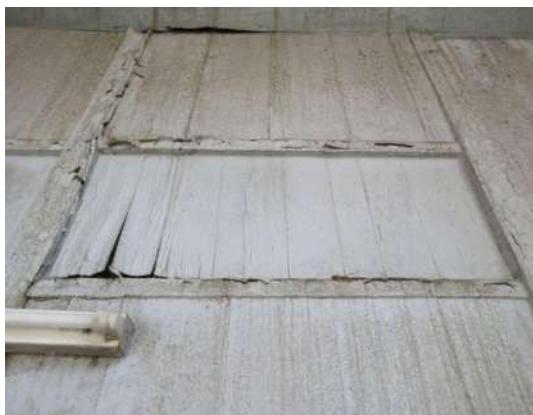
写真 3-1-124 浴室欄間 劣化状況
