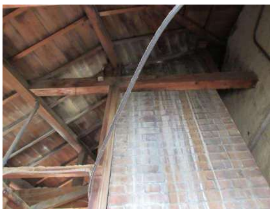
写真 3-1-163 煙突レンガ部の雨漏り痕跡
