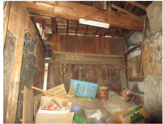
写真 3-1-27 燃料となる木片置場
