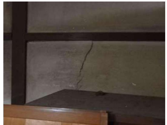
写真 3-1-87 壁のクラック
