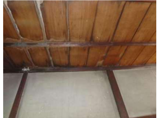
写真 3-1-83 階段室 著しい雨漏り痕跡
