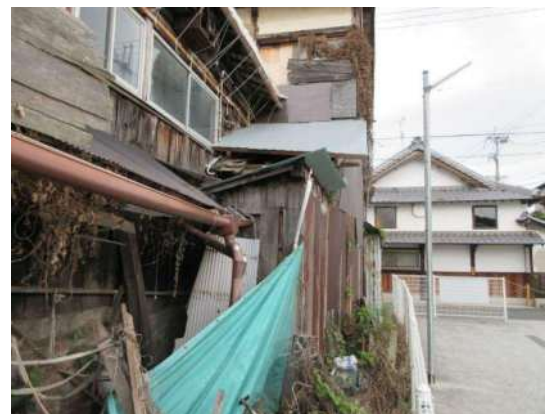
写真 3-1-76 建物側に雨水が流れる屋根
