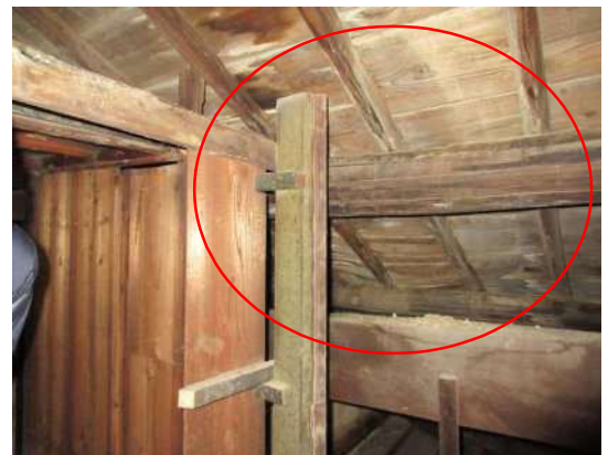
写真 3-1-141 葺き土の流入
