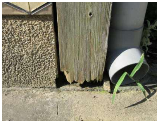
写真 3-1-80 柱脚腐朽による部分欠損
