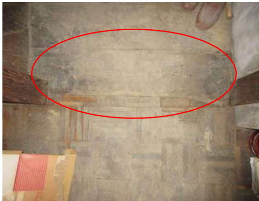
写真 3-1-71 階段前室 床板の腐朽
