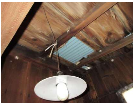
写真 3-1-75 便所天井の破損
