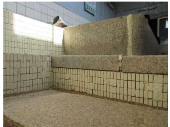
写真 3-1-131 タイルの欠損と修理痕跡
