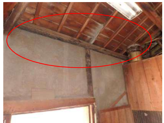
写真 3-1-145 桁が二重で下桁は焦げている
