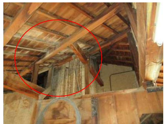
写真 3-1-162 瓦の不具合による雨漏り
