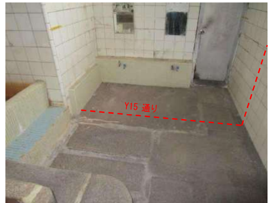
写真 3-1-230 モルタルにより塗り重ねられた床
