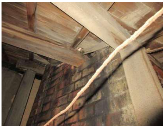
写真 3-1-43 レンガ煙突部と梁の強引な納まり
