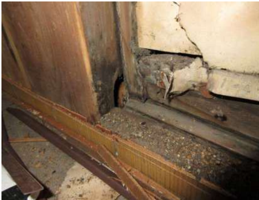
写真 3-1-190 窓廻りの柱の腐朽
