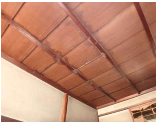
写真 3-1-90 座敷天井の雨染み
