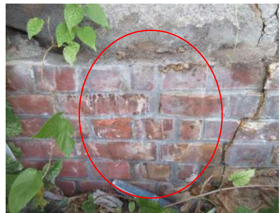
写真 3-1-226 継手部分のレンガ積み レンガの積み方に不自然さがあり、木口積みとなっている箇所がある
