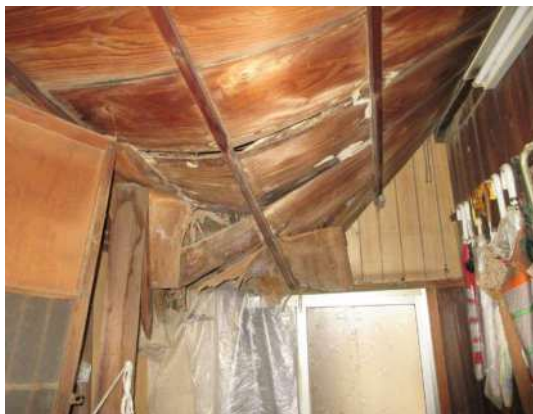
写真 3-1-73 階段前室屋根の崩落
