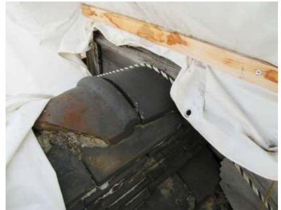
写真 3-1-105 雁振瓦の割れ
