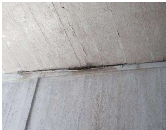
写真 3-1-122 天井板の腐朽（南面）
