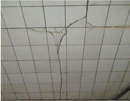
写真 3-1-116 目地によらないタイルのクラック（西面）
