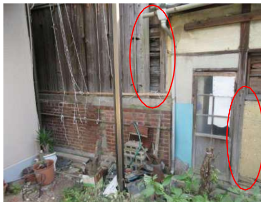
写真 3-1-81 板壁の欠損、漆喰剥離
