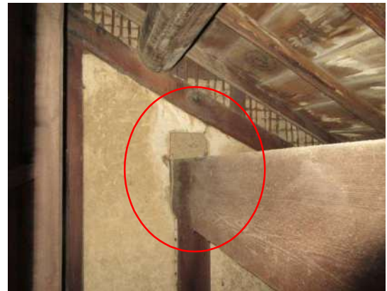
写真 3-1-133 妻桁圧壊による束・敷桁の垂下
