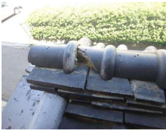
写真 3-1-94 塀 棟瓦の割れ
