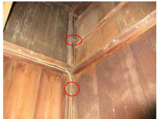
写真 3-1-186 X4-Y8 柱 高窓敷鴨居の痕跡
