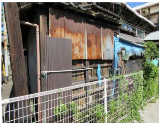
写真 3-1-169 外壁板金の欠損と劣化
