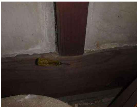
写真 3-1-88 妻桁の腐朽による圧壊
