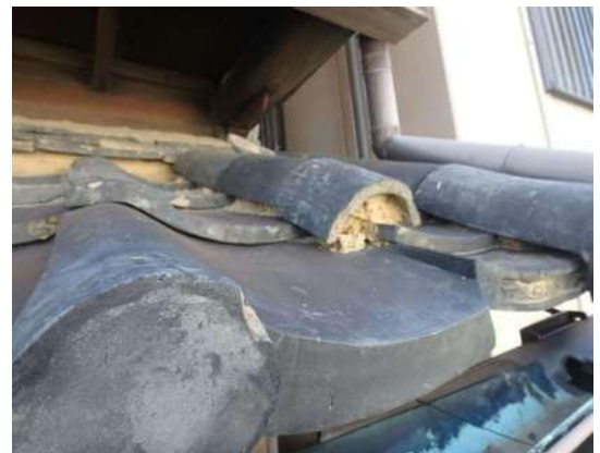
写真 3-1-97 素丸瓦の欠損
