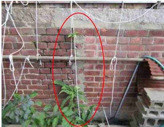
写真 3-1-223 レンガ基礎の継手（西面） レンガ基礎が延長された痕跡（右手が増築） 境目の左右で目地の仕様が異なる
