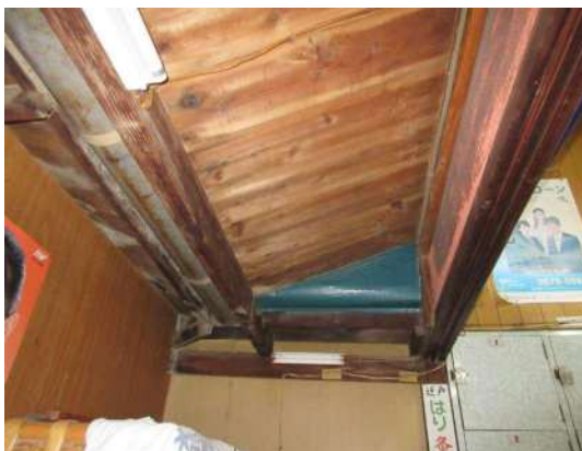
写真 3-1-60 樋の劣化と野地板雨染み
