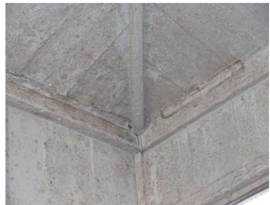
写真 3-1-123 天井板の腐朽（北東隅）
