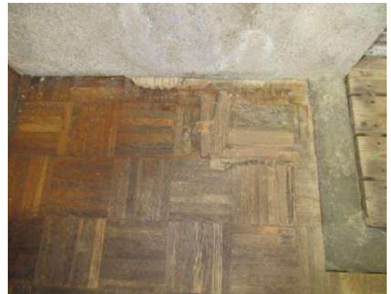
写真 3-1-68 浴室付近の床板の劣化
