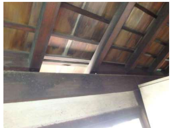
写真 3-1-93 面戸板の欠損
