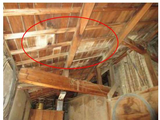
写真 3-1-164 野地板の腐朽
