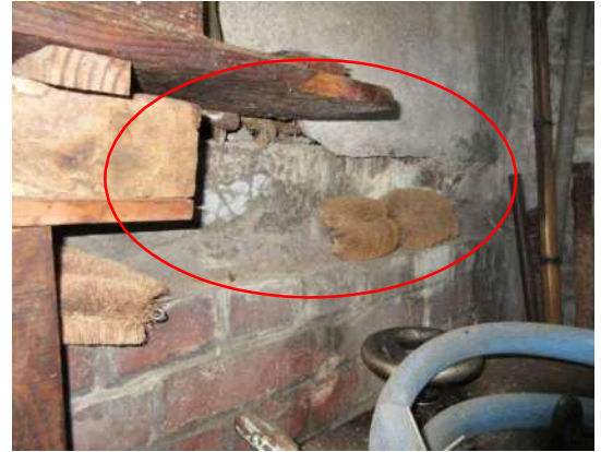
写真 3-1-172 モルタル壁の崩落
