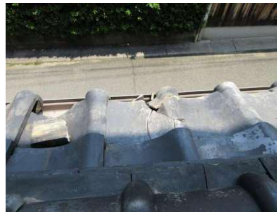
写真 3-1-95 軒先瓦の割れと欠落
