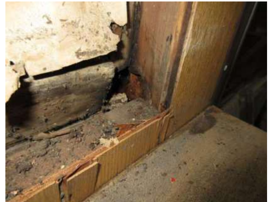
写真 3-1-191 窓廻りの柱の腐朽
