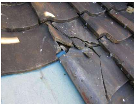
写真 3-1-155 著しい瓦の割れ
