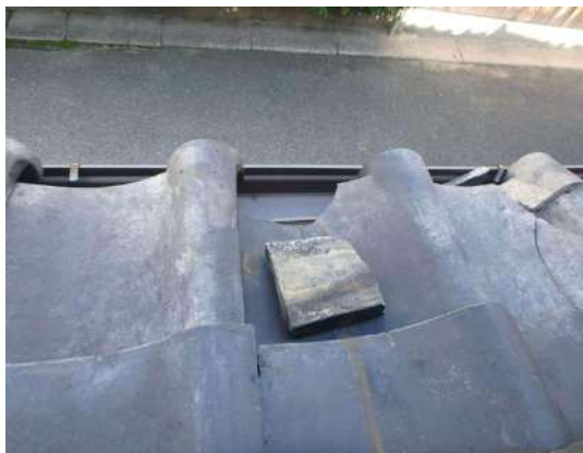
写真 3-1-96 割れた瓦が置かれている
