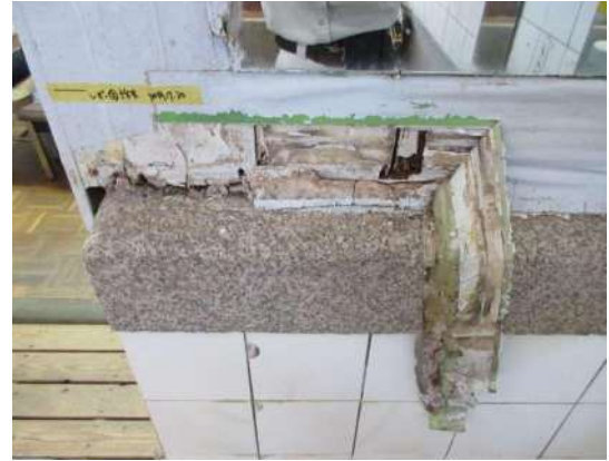
写真 3-1-113 高基礎と接する木部の腐朽
