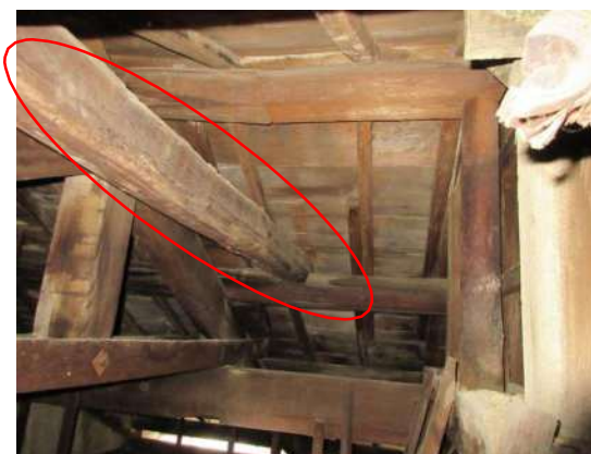
写真 3-1-218 当初の越屋根受け梁 Y10 通り付近 母屋から母屋へ架け渡す
