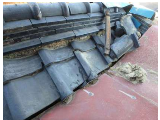
写真 3-1-99 瓦屋根の崩壊と葺き土の表出
