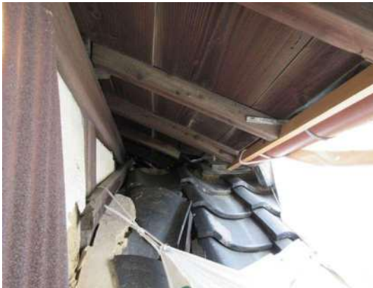
写真 3-1-104 浴室棟大棟と表棟の接続部の乱れ
