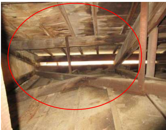
写真 3-1-136 野地板の腐朽、垂木の折損
