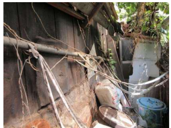
写真 3-1-176 東側下屋 板壁の劣化
