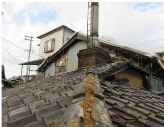
写真 3-1-153 隅棟瓦の欠損
