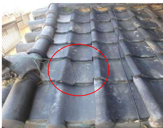
写真 3-1-63 玄関屋根 平瓦の割れ
