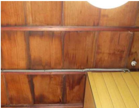
写真 3-1-67 1 階天井の雨漏り
