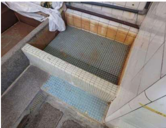
写真 3-1-130 副浴槽モザイクタイルの部分欠損
