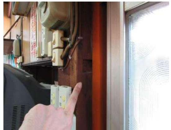
写真 3-1-195 X11-Y3 柱 鴨居痕跡
