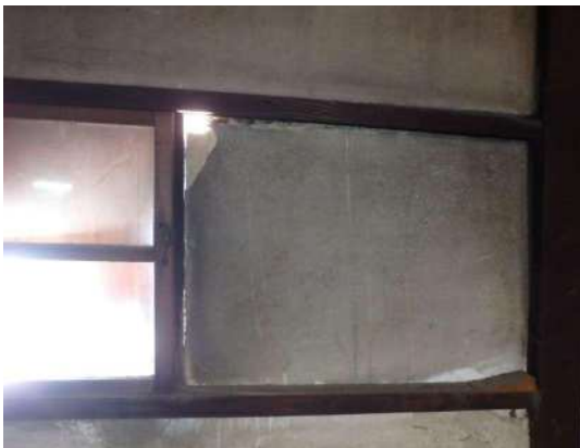
写真 3-1-86 著しい散り切れによる壁の穴
