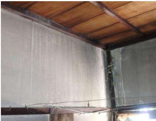
写真 3-1-84 小壁の雨染みと植物の侵入
