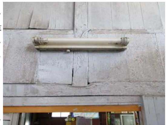
写真 3-1-109 楣の圧壊（浴室（男））
