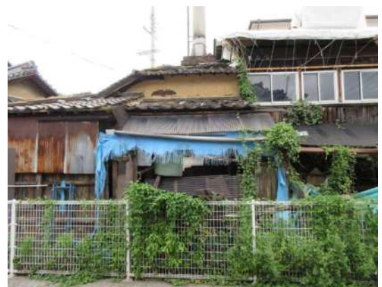
写真 3-1-178 応急処置が為された下屋屋根
