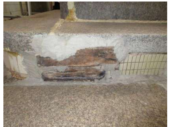
写真 3-1-129 モザイクタイルの欠損
