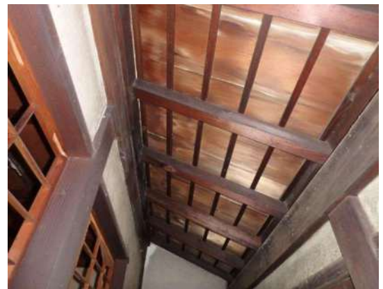
写真 3-1-91 縁側 垂木掛け付近の雨染み
