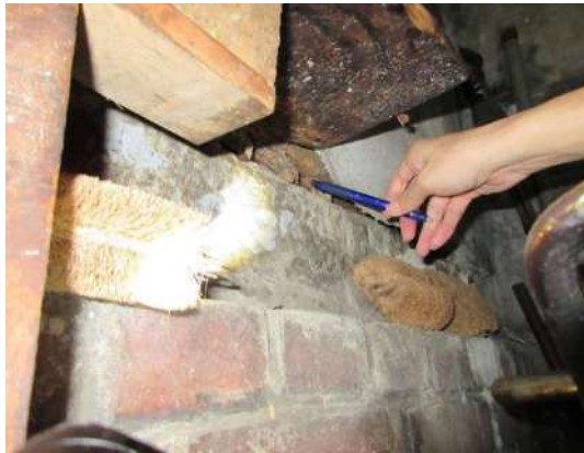
写真 3-1-171 レンガ基礎上部の土台の腐朽
