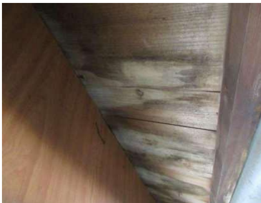
写真 3-1-58 塀の屋根の野地板の雨染み
