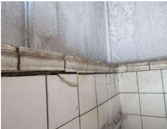
写真 3-1-118 笠木タイルの割れ
