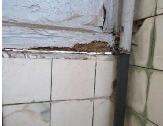
写真 3-1-112 間仕切り土台の腐朽
