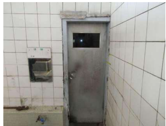
写真 3-1-125 釜場出入口廻りの額縁の腐朽
