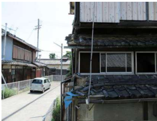
写真 3-1-98 塀東側及び庇の崩落
