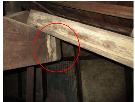
写真 3-1-211 土壁（妻壁）の痕跡
