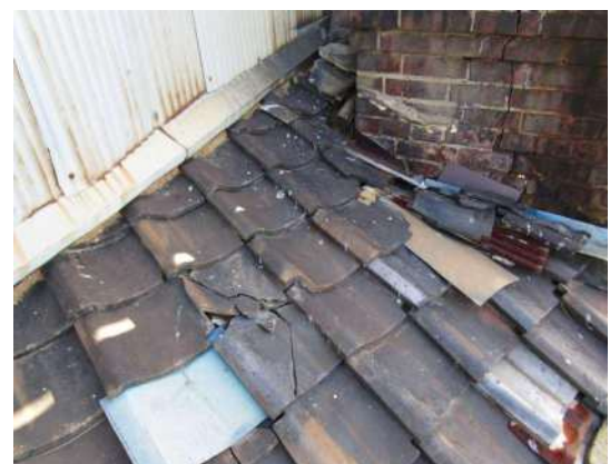
写真 3-1-156 煙突廻りの瓦の不具合
