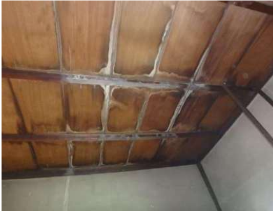
写真 3-1-82 階段室 著しい雨漏り痕跡
