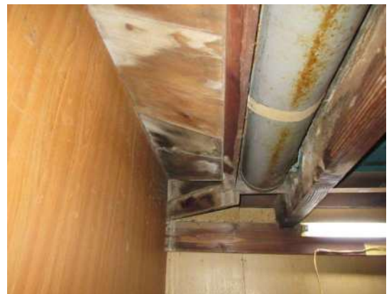
写真 3-1-59 隅部に集中する雨染み
