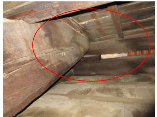
写真 3-1-139 小屋組材の雨染み
