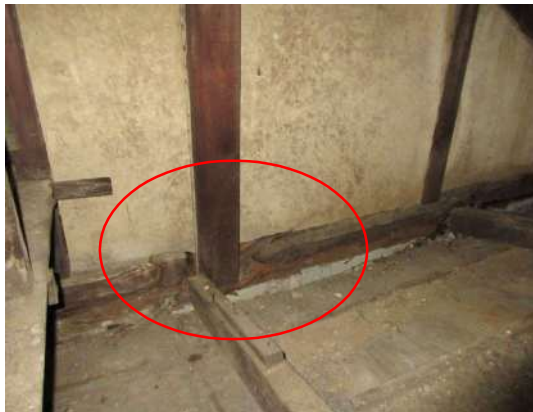
写真 3-1-132 妻桁の腐朽と束による圧壊
