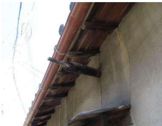
写真 3-1-175 壁の著しい割れ
