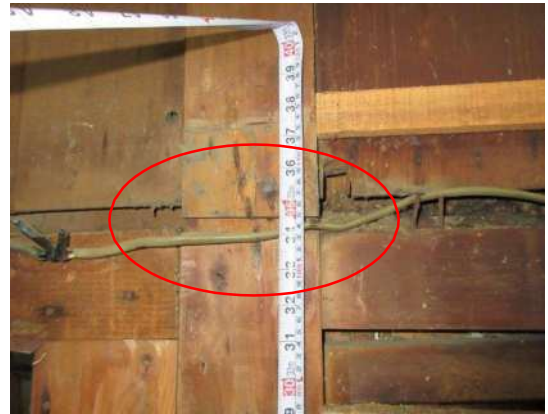
写真 3-1-178 内法長押の首切り痕跡
