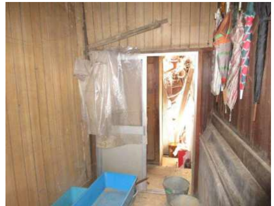
写真 3-1-72 階段前室 壁板の劣化
