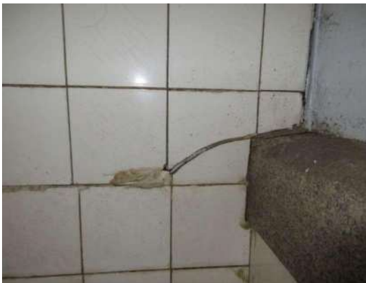
写真 3-1-120 腰壁笠木との接続部でのタイル割れ
