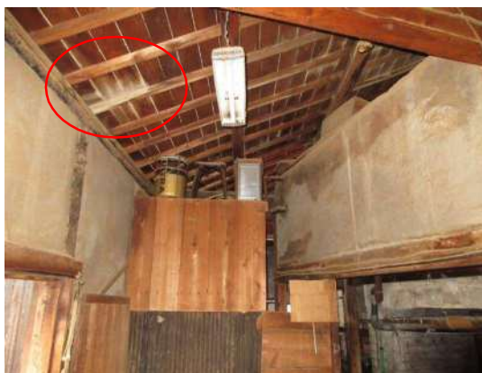
写真 3-1-161 野地板の腐朽と葺き土の流出
