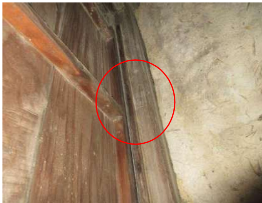
写真 3-1-185 X1-Y8 柱 高窓敷居の痕跡
