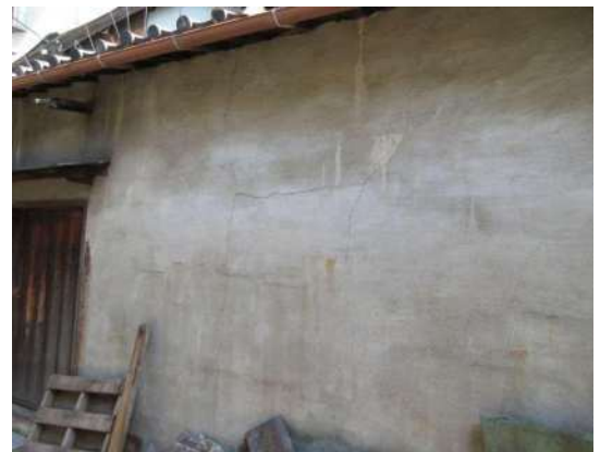
写真 3-1-168 壁の全面的なクラック
