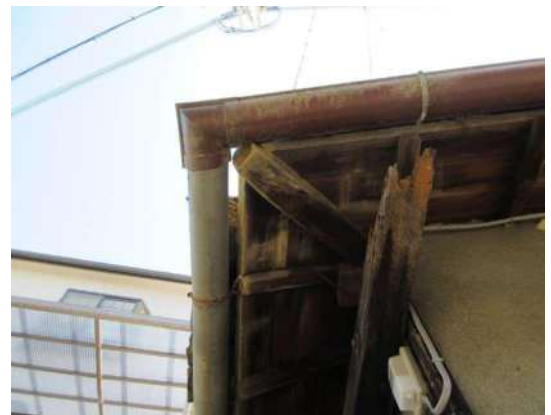
写真 3-1-174 野地板の腐朽と隅木への葦土流出
