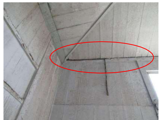
写真 3-1-111 桁下端の腐朽
