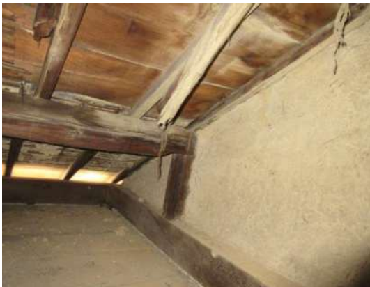
写真 3-1-107 腐朽による垂木の折損
