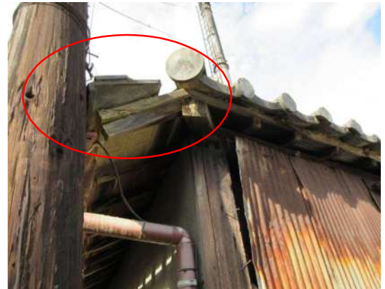
写真 3-1-158 落下しそうになっている軒先瓦
