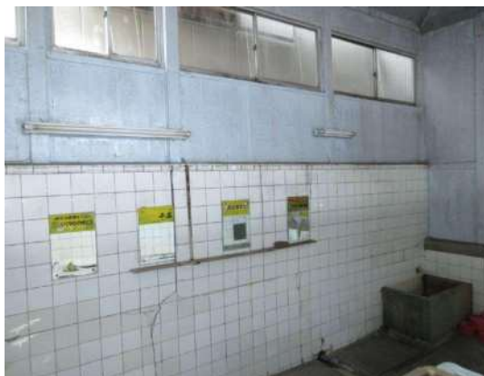
写真 3-1-114 タイル壁の孕み出し
