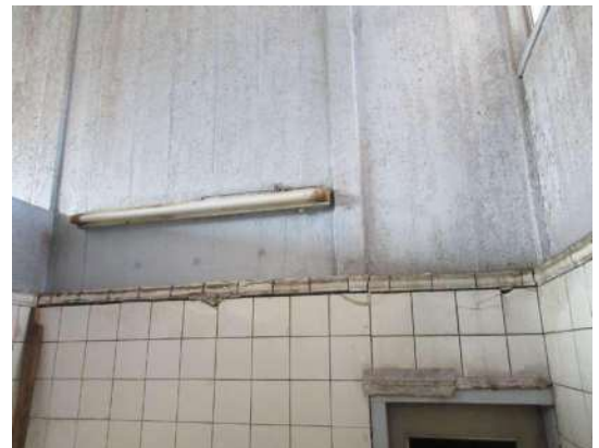
写真 3-1-121 板壁の塗装劣化
