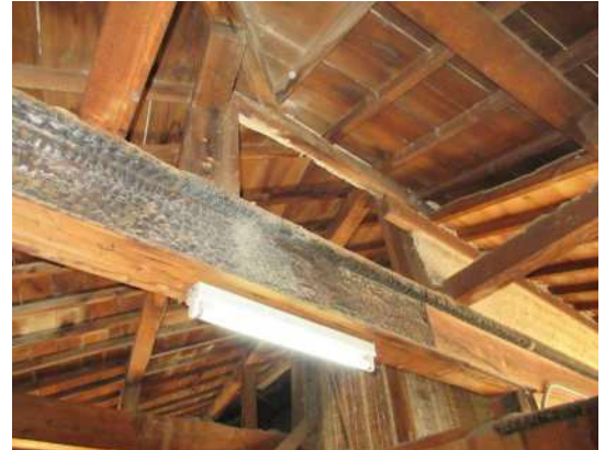
写真 3-1-232 焦げた梁に束立として 屋根を支える
