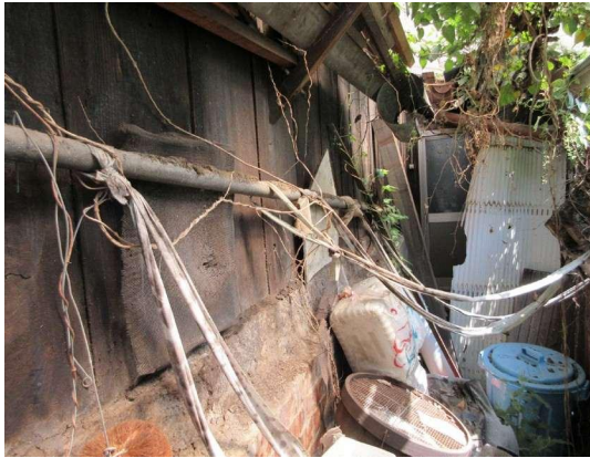
写真 4-1-10 東側下屋に置かれた不用物
