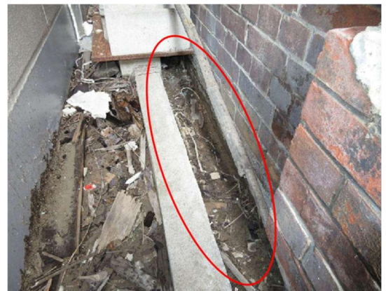
写真 4-1-13 土が堆積した排水路
